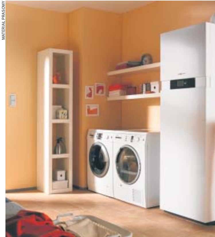
Kocioł firmy Viessmann zainstalowany w łazience
